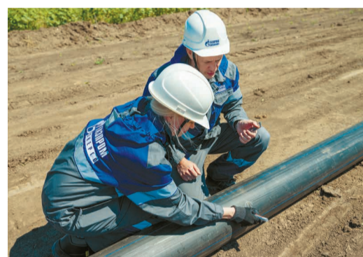
Специалисты группы строительного контроля ИТЦ проводят визуальный и измерительный контроль дефектов на ПЭ-трубе
