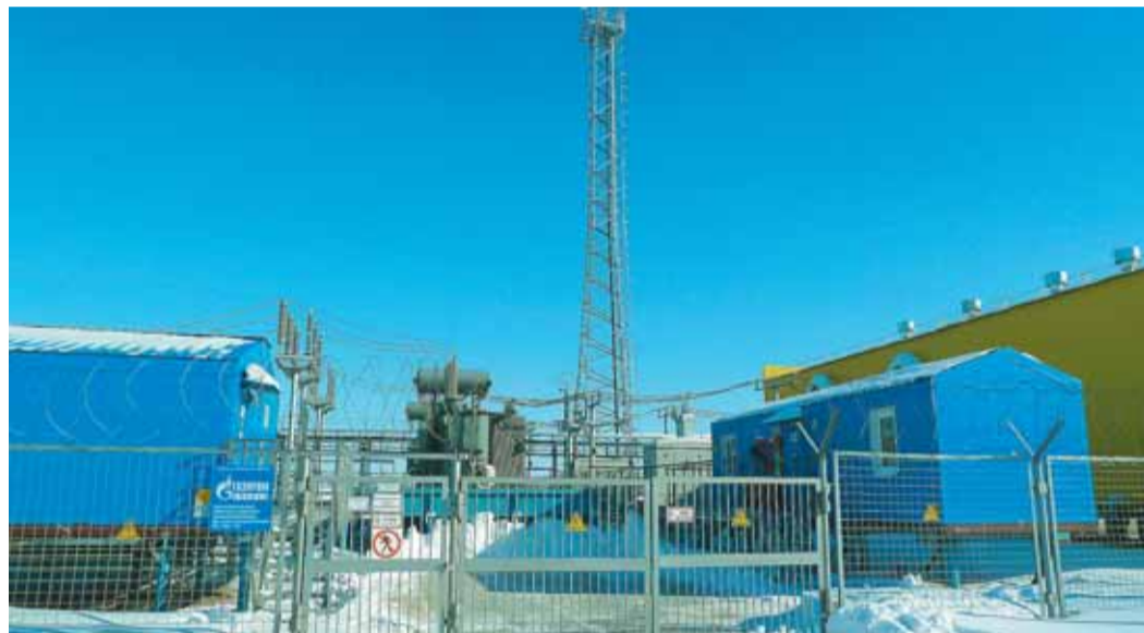
Цех сетей электроснабжения Заполярного управления энергоснабжения. Понижающая электрическая подстанция ПС-110/6
