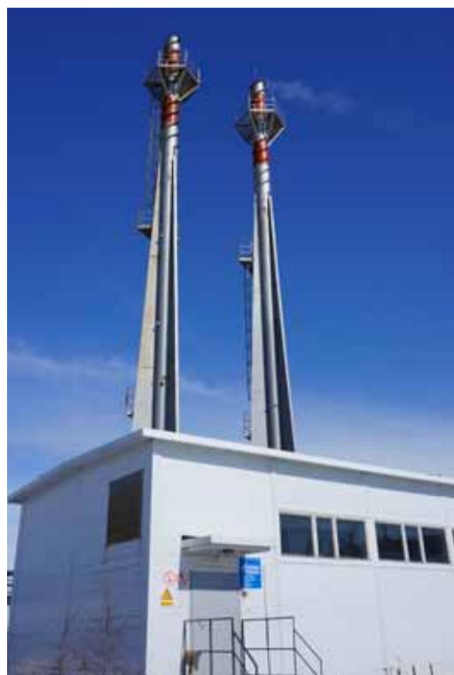
Котельная № 6. ВЖК при УКПГ-2с. ЗНГКМ
